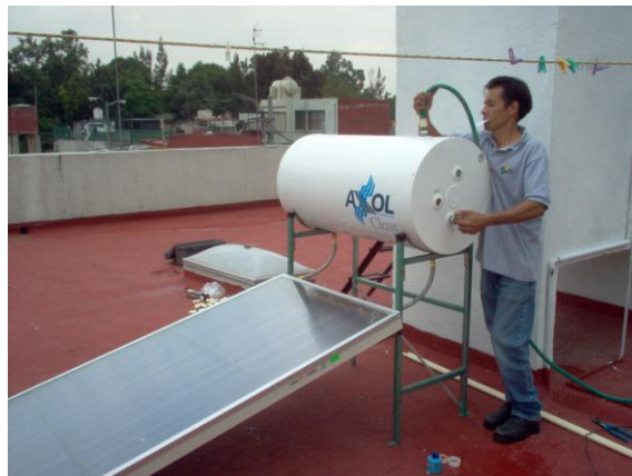
Foto N°7.- Llenado del termotanque con agua.
