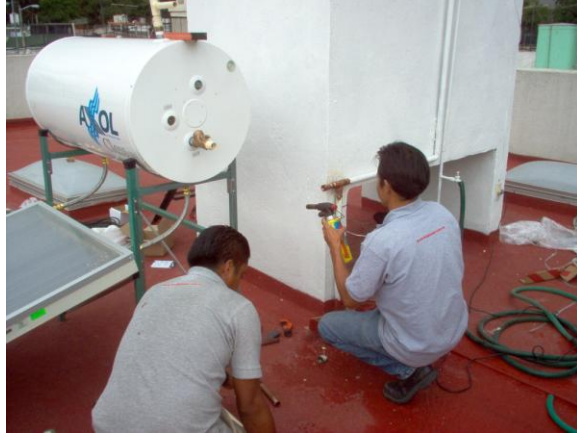
Foto N° 8.- Soldado de las piezas metálicas que unen el tinaco y el calentador solar.
