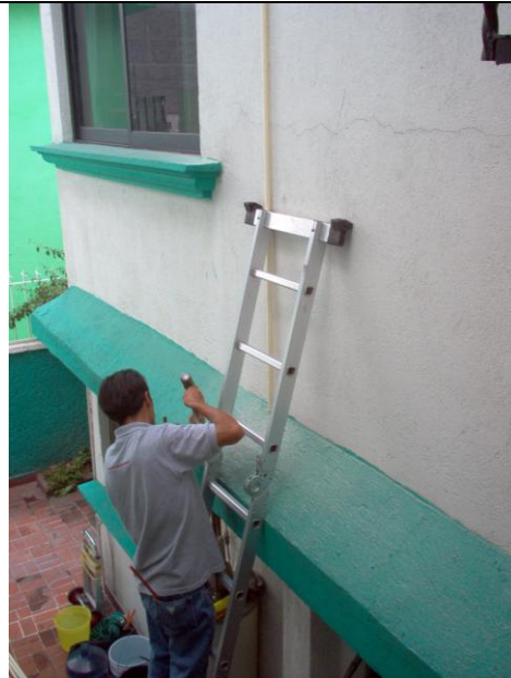
Foto N° 9.- Bajada de agua precalentada hacia el calentador de gas.
