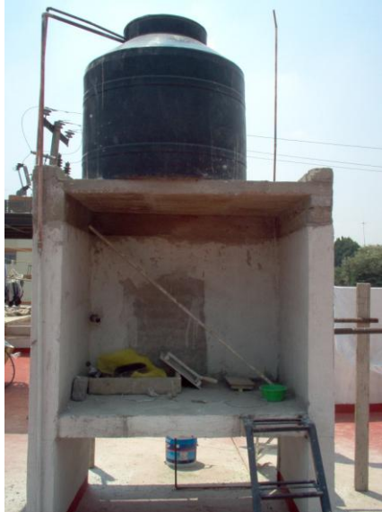
Foto N° 2.- Posición final del tinaco de la oficina del Cinam, 2.20 m de la azotea a la base del tinaco. Hubo que rehacer todas las conexiones.
